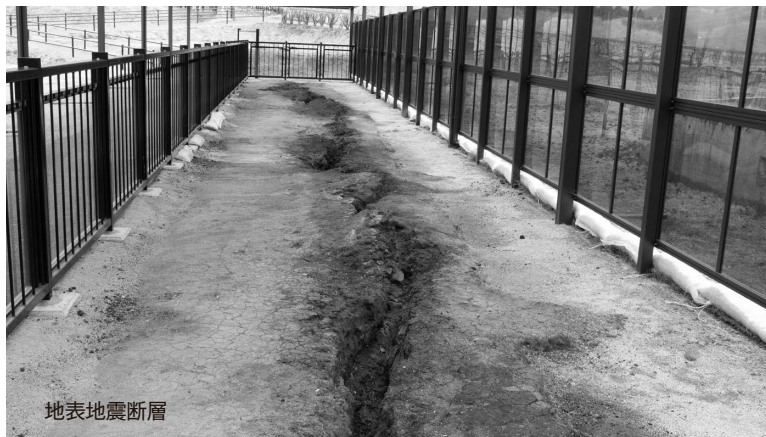
校舎玄関前の地割れ
