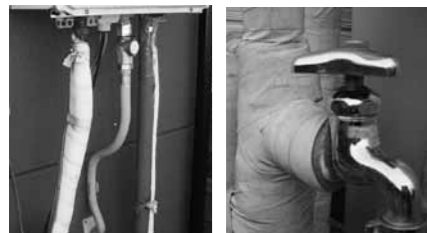
水道管を始め、給湯器の管なども保温チューブを巻くことで事前に凍結を予防することができます。
