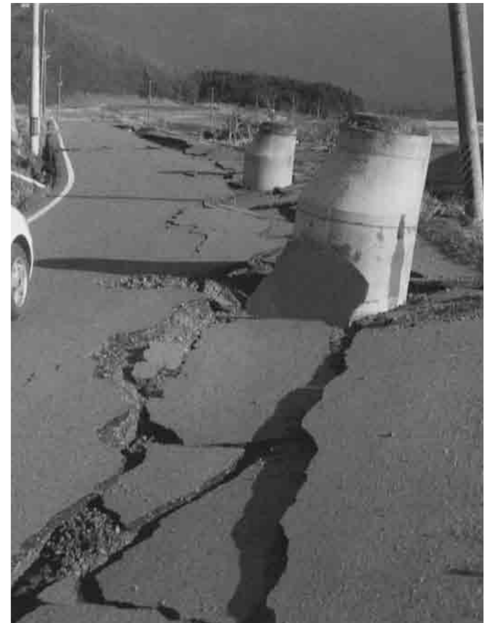
福島県矢吹町の地震被害。※ 出典：【東日本大震災追記録誌矢吹町～あの日と今～】
