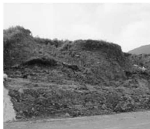
▲崩壊した法面(黒目～清水間)
