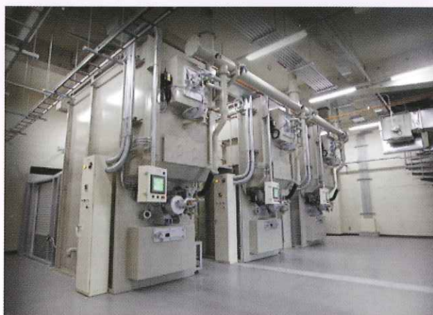
火葬炉 (炉作業室)
